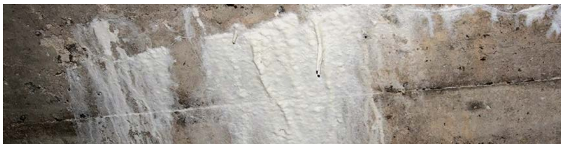
Дефекты коррозионного характера
