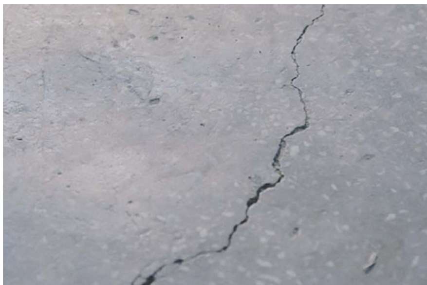
Рисунок 8.6.1 — Подвижная трещина в полу
