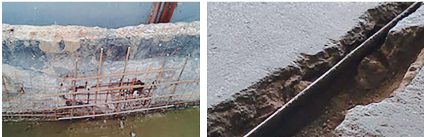
Рисунок 8.3.5.1 — Объемные разрушения бетона
