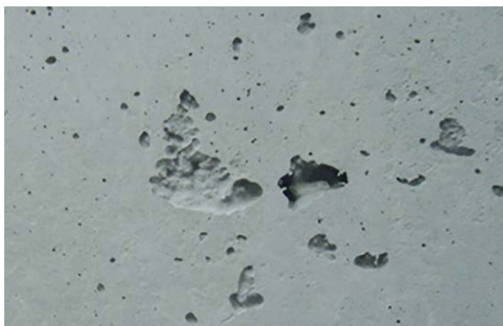
Рисунок 8.3.6.1 — Дефекты бетонной поверхности
