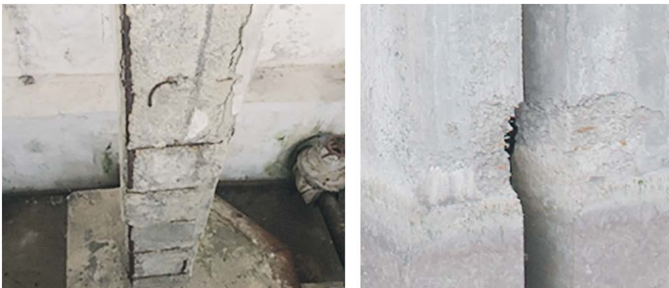
Рисунок 8.3.2.2 — Несущие железобетонные колонны с поврежденным защитным слоем бетона и участками оголенной арматуры
