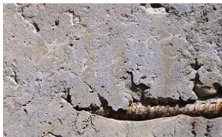
Полости от зависания бетонной смеси
