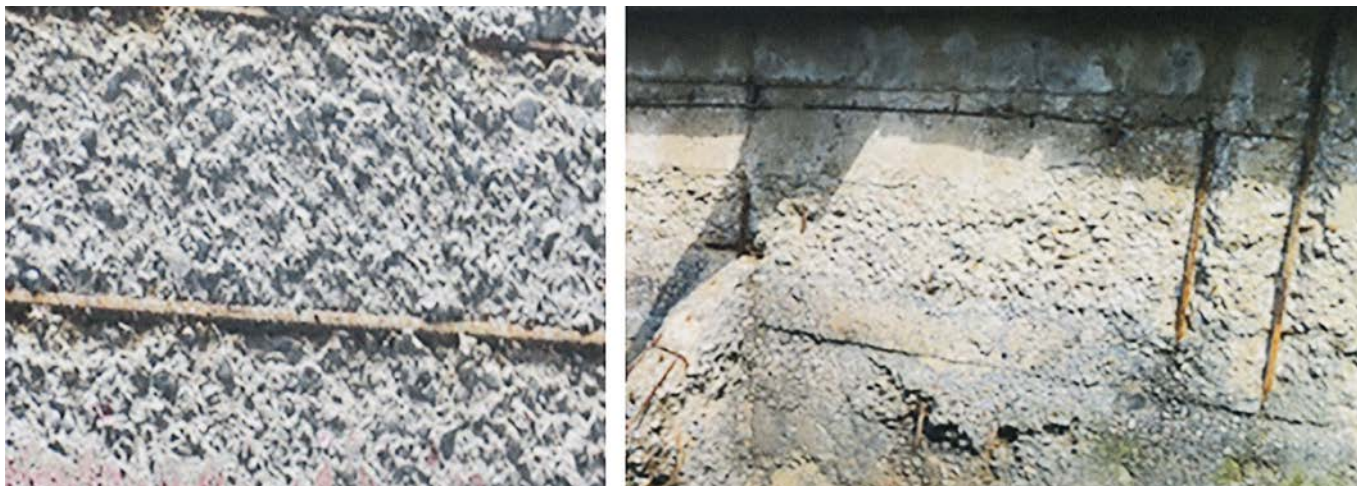
Рисунок 8.3.2.1 — Разрушенные участки бетона с оголенной арматурой
