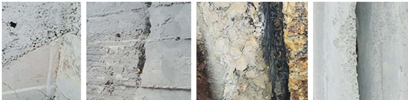
Рисунок 8.3.1.1 — Поверхностные дефекты бетона
